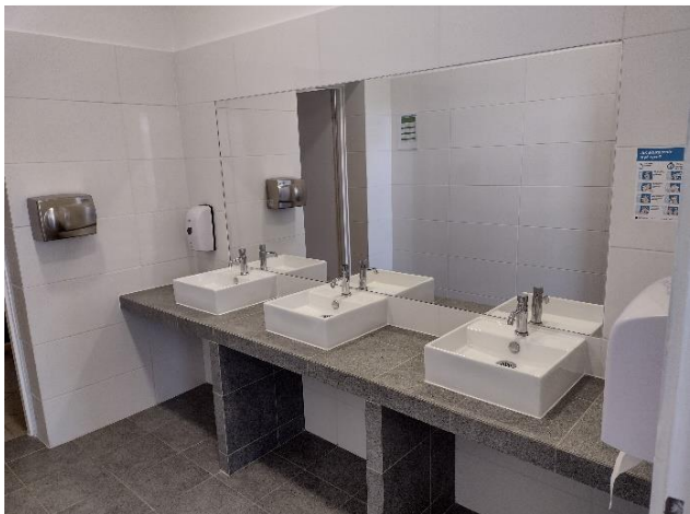
Rys. 7. Pomieszczenie sanitarne w Przedszkolu Nr 4 w Wągrowcu
